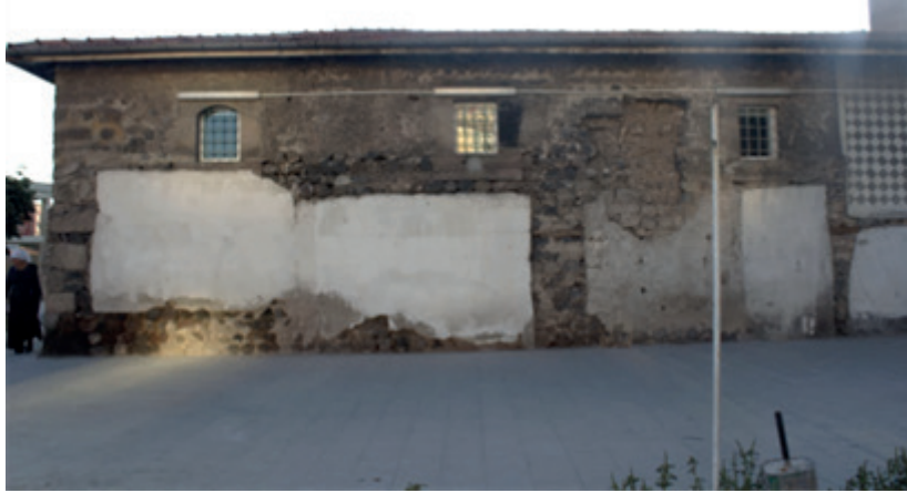
Resim 17. Deliklitaş Mescidi Batı Cephe Yüzeyinde Sıva ve Kalıntı İzleri
